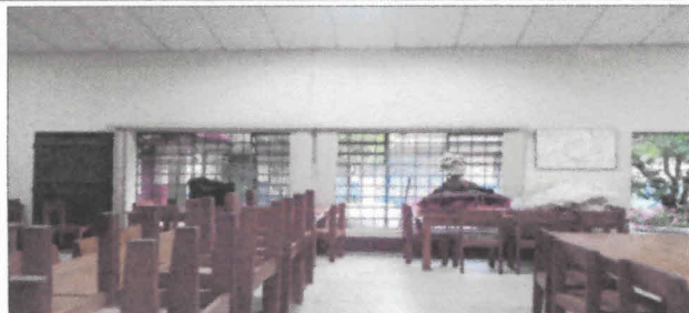
Foto 1: Pintura interior en paredes de biblioteca, es necesaria la aplicación de pintura en paredes ya que se están deteriorando.
