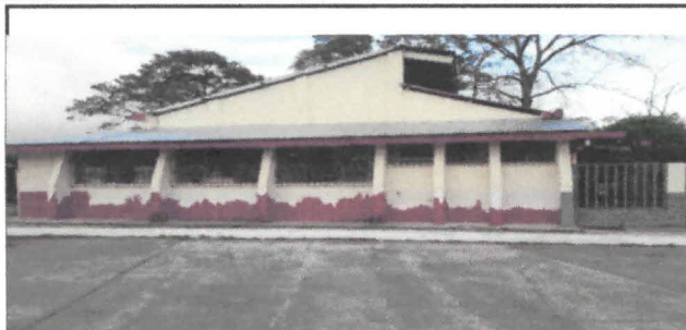
Foto 2: Pintura exterior área de biblioteca, paredes en la parte exterior de biblioteca necesitan remosamiento para la protección de paredes zocalo y azulejo.
