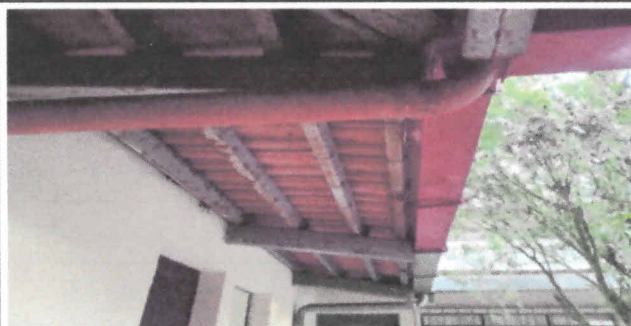
Foto 4: Cambio de techo de teja , exterior de biblioteca, es necesario la teja esta deteriorandose.
